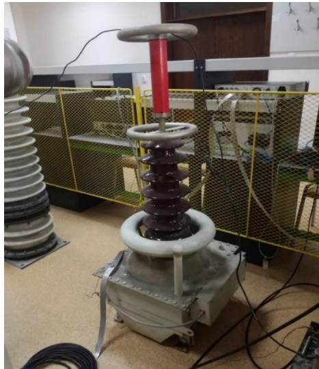
Fig. 1 – Transformatorul de încercare al sursei WPT 4,4/100
