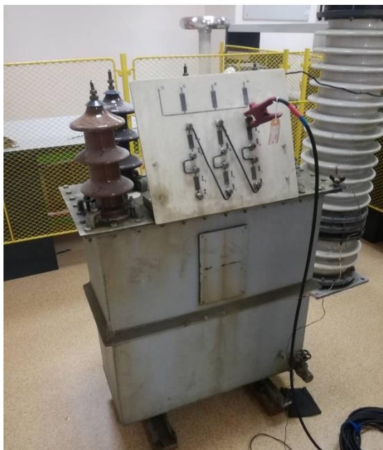
Fig. 5 – Transformatorul de medie tensiune folosit pentru efectuarea încercărilor
